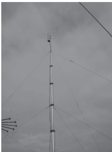
Фото 5. Выносной датчик поля АРГАМАК-ИС на мачте стационарной станции радиоконтроля
